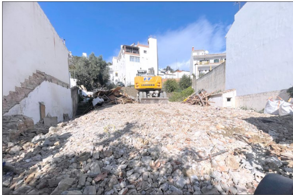
Imagen de los trabajos de demolición llevados a cabo el pasado enero.
