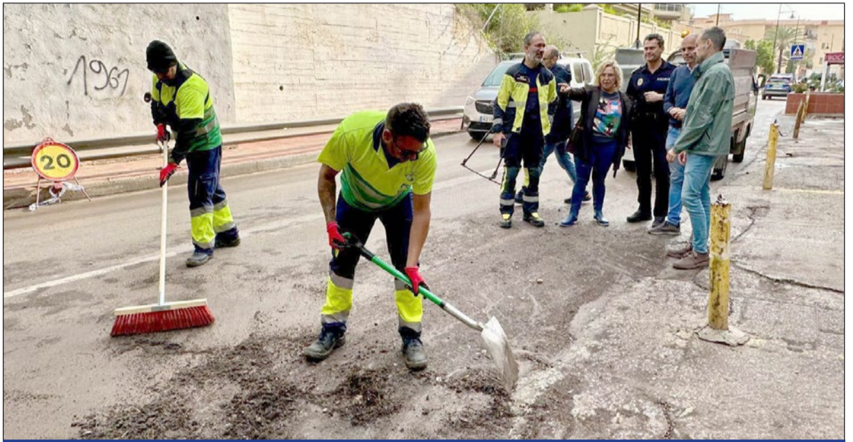
La alcaldesa, Ana Mula, inspecciona los lugares de la ciudad afectados por la DANA.
