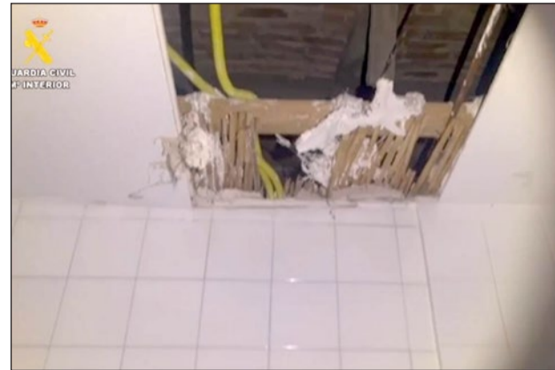
Hueco en el techo de la vivienda por donde habría escapado el detenido.
